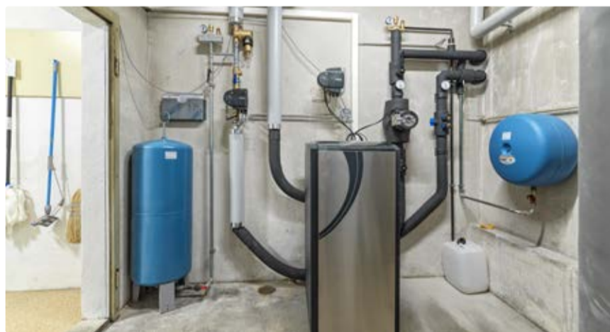
Mit der kostenlosen und neutralen Impulsberatung «erneuerbar heizen» unterstützen wir Sie beim Ersatz Ihrer bestehenden Heizung.
