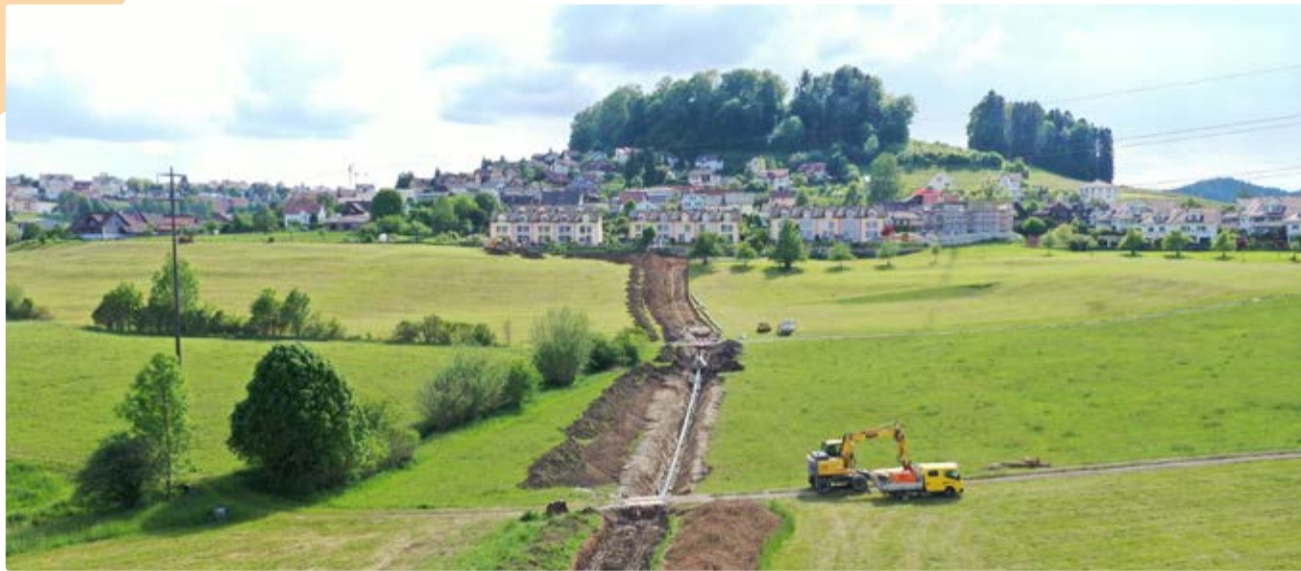
Die Fernwärmeleitung der RWT führt von Bazenhaid bis nach Kirchberg.
