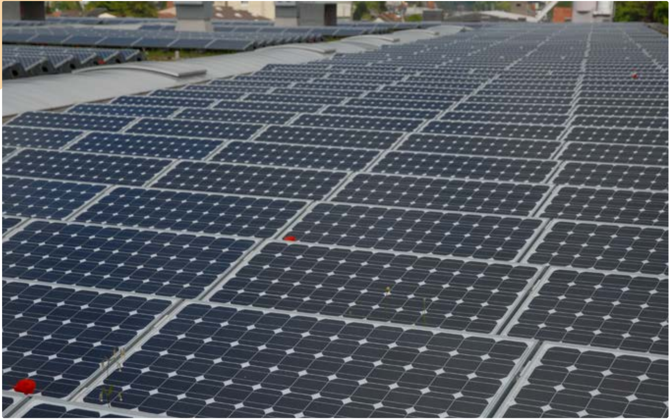
Der Ausbau von erneuerbarer Energie im Kanton St. Gallen, gerade im Bereich von Photovoltaik, läuft gut. Dennoch muss noch viel mehr Solarstrom produziert werden, um die Ziele des Energiekonzepts 2021-2030 zu erreichen.
