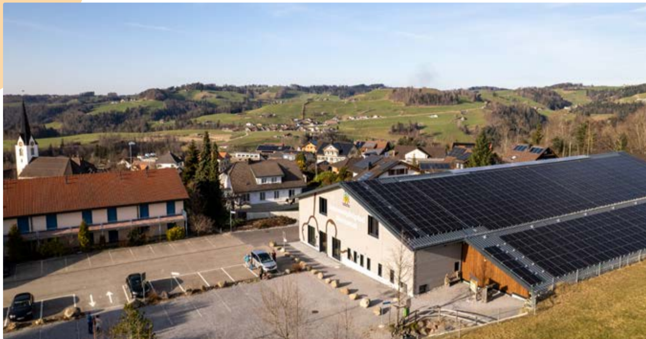
Die Photovoltaikanlage auf der Parkgarage des Baumwipfelpfads ist so gross dimensioniert, dass sie einen grossen Teil des Dorfes Mogelsberg mit Strom versorgen kann.
