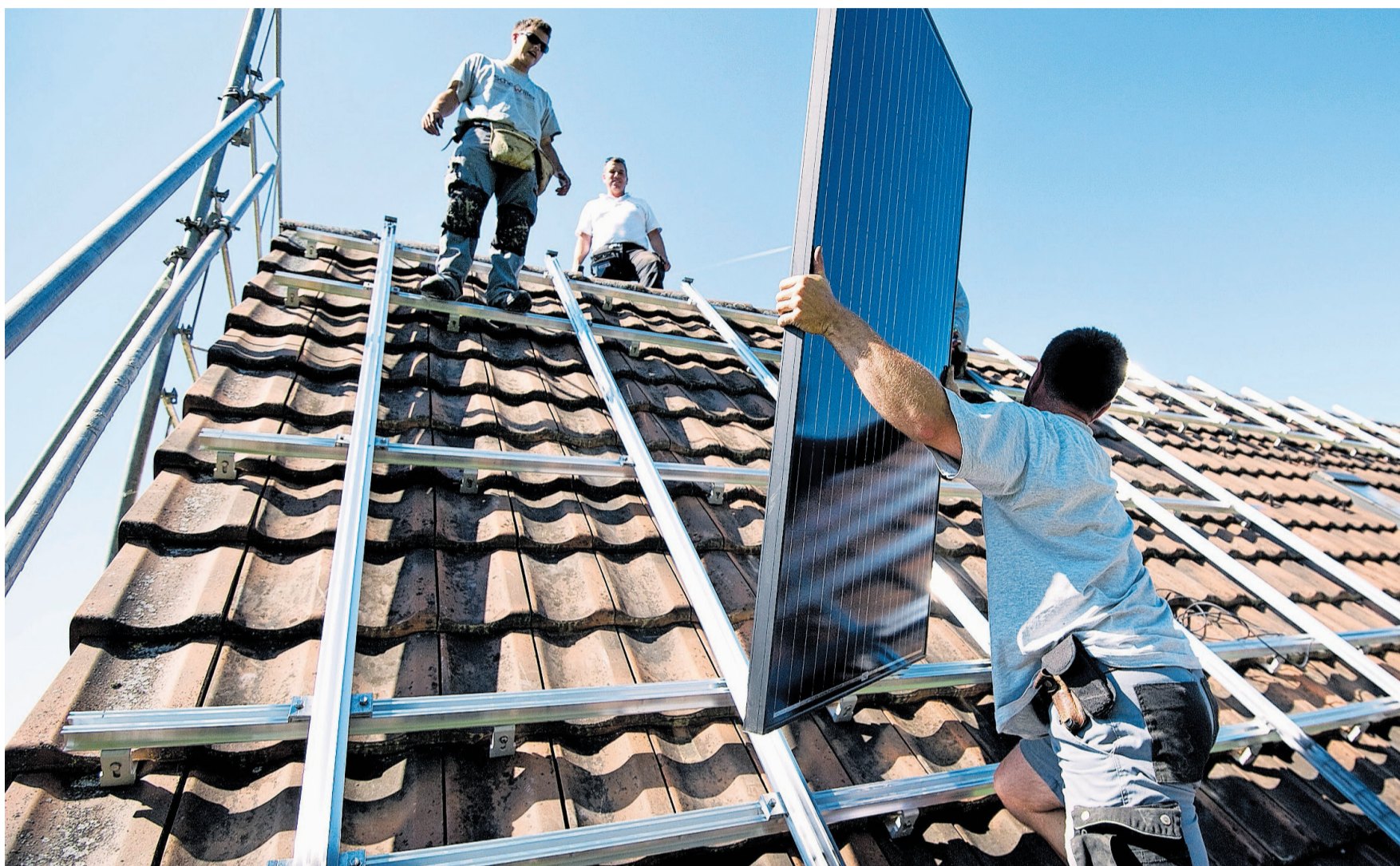
Die Förderung der PV-Anlagen wird in der Gemeinde Uzwil über die Energieagentur St. Gallen abgewickelt.
